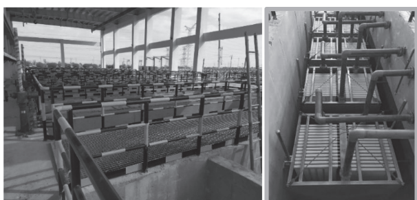
写真5 中国・都市下水処理場 膜ユニット設置写真
