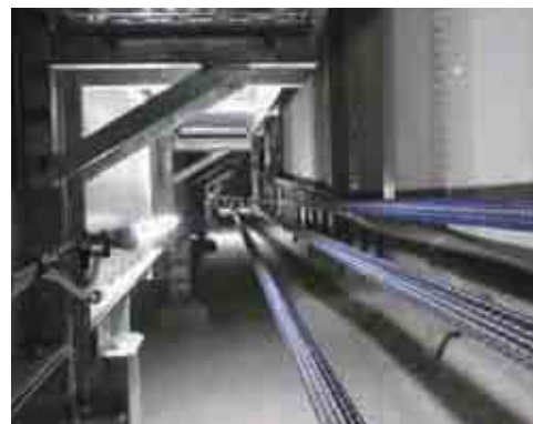
裏高尾橋の狭い桁内空間に設置されたPCケーブル
